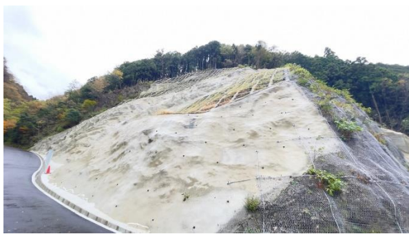
崩落斜面 写真
